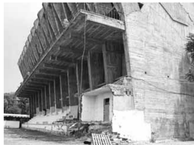
O perigo iminente de derrocada do Pavilhão do Dramático é uma ameaça para os 30 trabalhadores que estão instalados na cave
